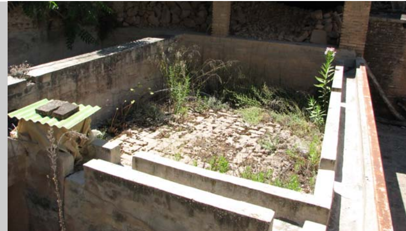
11 Balsa de decantación
